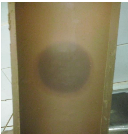
Figura 7 - Mancha de umidade, telha de segunda linha.
