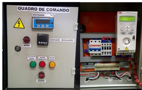
Figura 6 - Quadro de comando.
