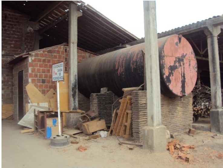
Figura 07. Tanque de óleo BPF.
